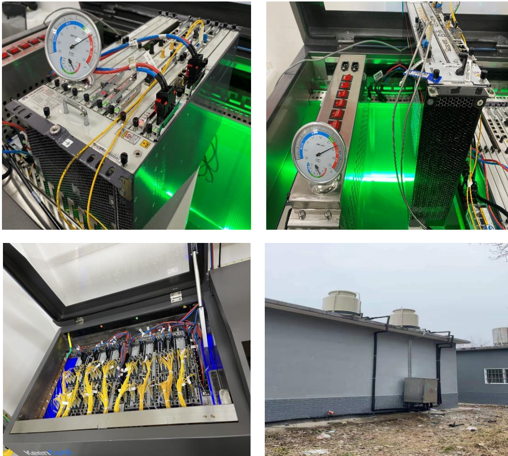
图 4 中国移动汇聚机房单相浸没式液冷试点
